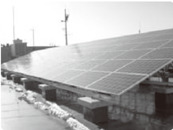
太陽光パネル(保谷南分庁舎)
