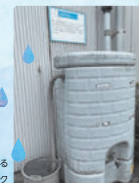
エコプラザ西東京にある 雨水貯留タンク
