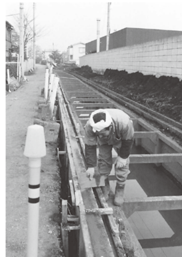
新川のふた掛け工事(中町一丁目。右側が保谷庁舎)昭和47(1972)年撮影 西東京市中央図書館地域・行政資料室所蔵
