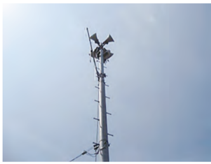
▶防災行政無線屋外スピーカー
