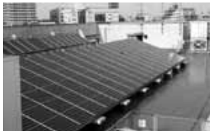
屋上の太陽光発電設備(田無庁舎)
