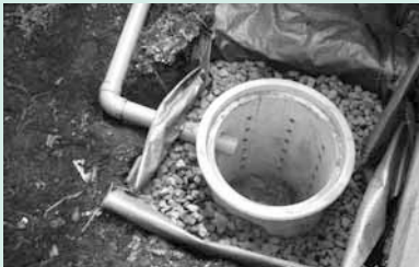
雨水浸透施設▲
