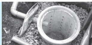
雨水浸透施設
