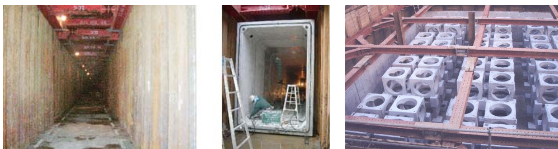
【道路下に設置した貯留施設 (住吉町三丁目地内)】
