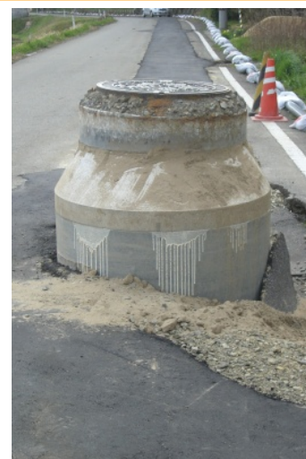
液状化によるマンホール浮上被害 （平成 19 年能登半島地震）
